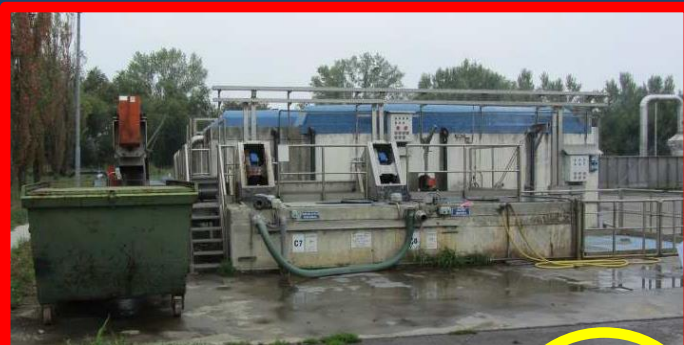
CONFERIMENTI, PRETRATTAMENTO, ACCUMULO PERCOLATI DI DISCARICA + ISPESSIMENTO DEI FANGHI CHIMICI
